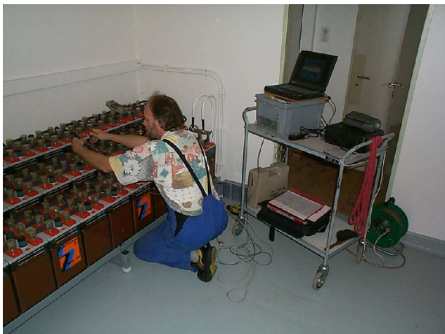
Messen einzelner Zellen an einer Akkumulatoren-Batterie
